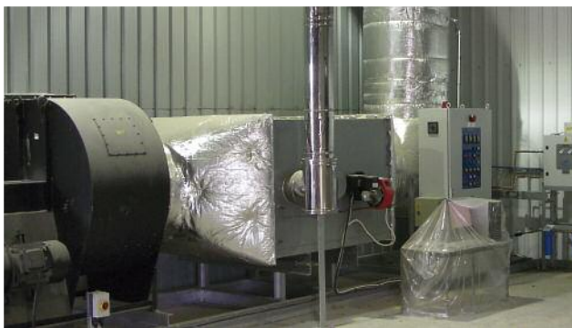
Umluftsysteme schaffen die Voraussetzung für eine gleichbleibende Temperatur- und Feuchtigkeitsverteilung innerhalb der Trockenkammer
